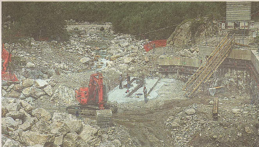
Cantiere stoppato Un'immagine dei lavori di costruzione della centralina prima dello stop giudiziario
